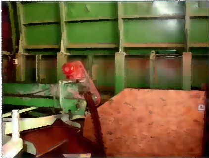
Bild 6 • Zudosierung von Konverterstaub vor dem Kollergang
