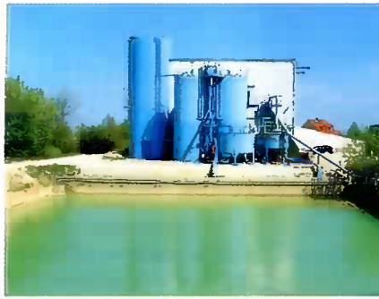
Anlage zum Wasserrecycling und zur Wiedergewinnung der wertvollen Mineralfracht.
